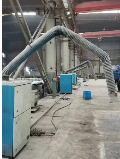
图 4-5 移动式焊接烟尘净化器
